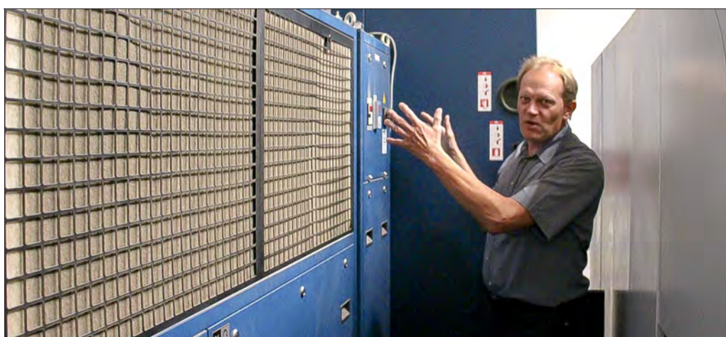
Das Herzstück des Energiekonzepts ist eine Erdwärmeanlage. Firmenchef Alexander Theinert steht vor dem Wärmerückgewinnungsaggregat, nebendran verbergen sich die Anschlüsse.
