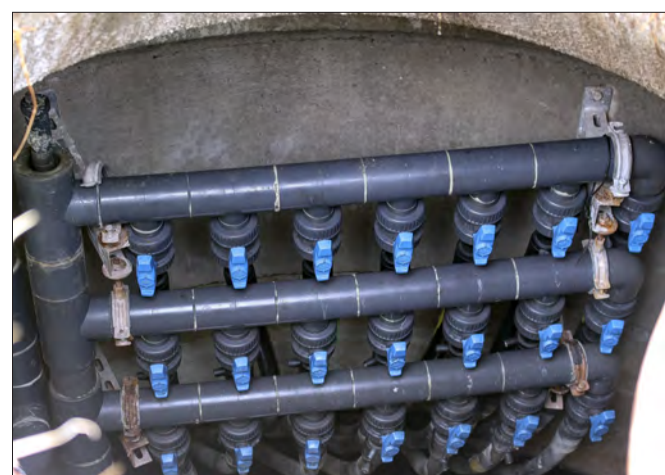
In einem Schacht sind die Anschlüsse für die Erdwärmeanlage, deren Rohre 6,5 Kilometer im Erdreich verlaufen.
